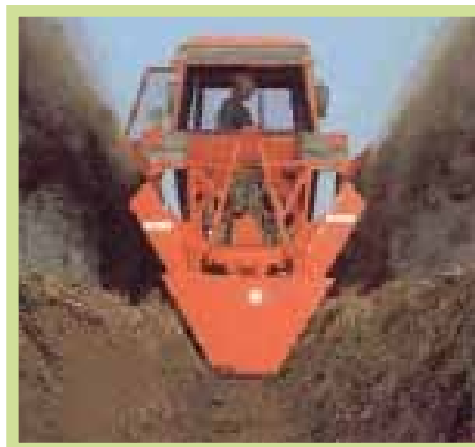
Macchina scavafossi. L'efficienza della rete di scolo è uno dei primi fattori da verificare
